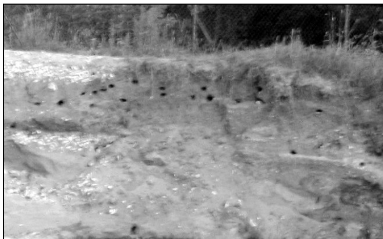
Rysunek 4. Wał przeciwpowodziowy uszkodzony przez zwierzęta nadwodne Figure 4. The embankment destroyed by the supraquatic animals
