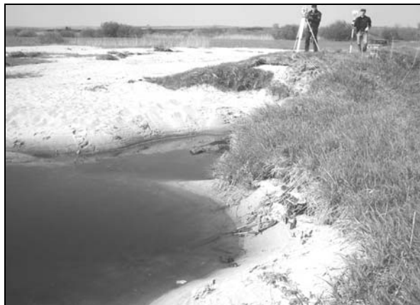
Rysunek 2. Widok pierwszego rozmycia wału przeciwpowodziowego Figure 2. The view of the first broken embankment
